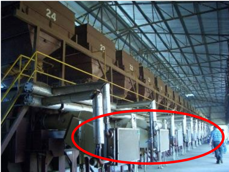
Radiadores – sistema con caldera
